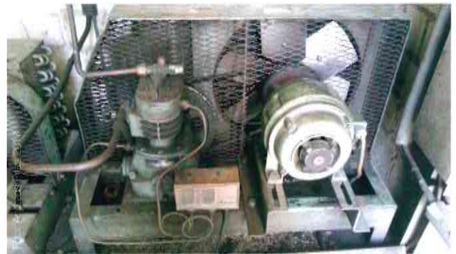
Eine Kälteanlage mit Einzelverdichtern.
